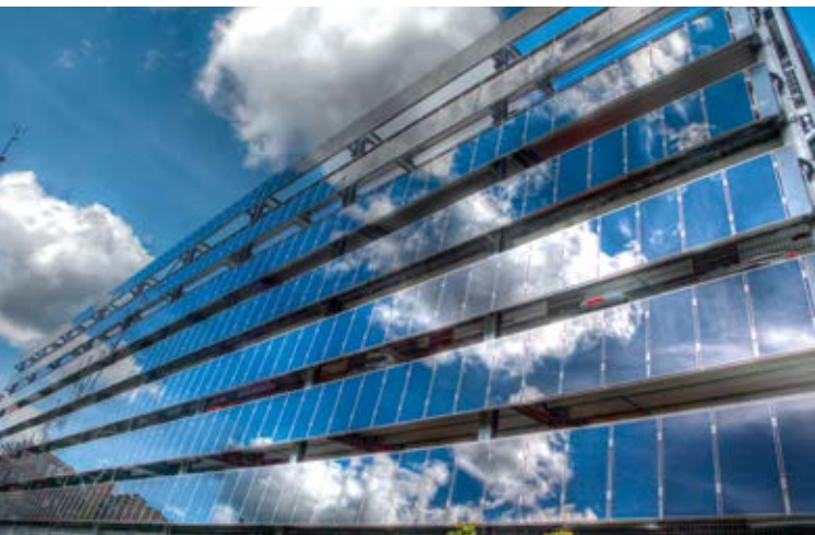
Abb. 11: Photovoltaik an der Parkhausfassade (Quelle: Robert Müller)
