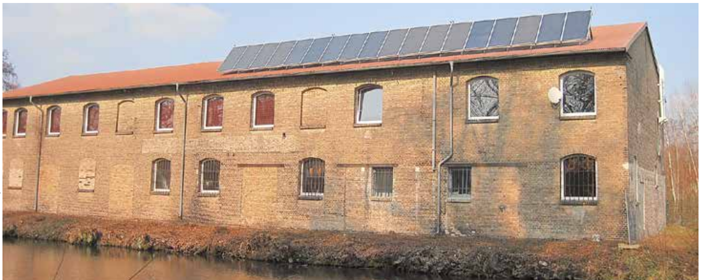
Solarthermie auf Altbestand
