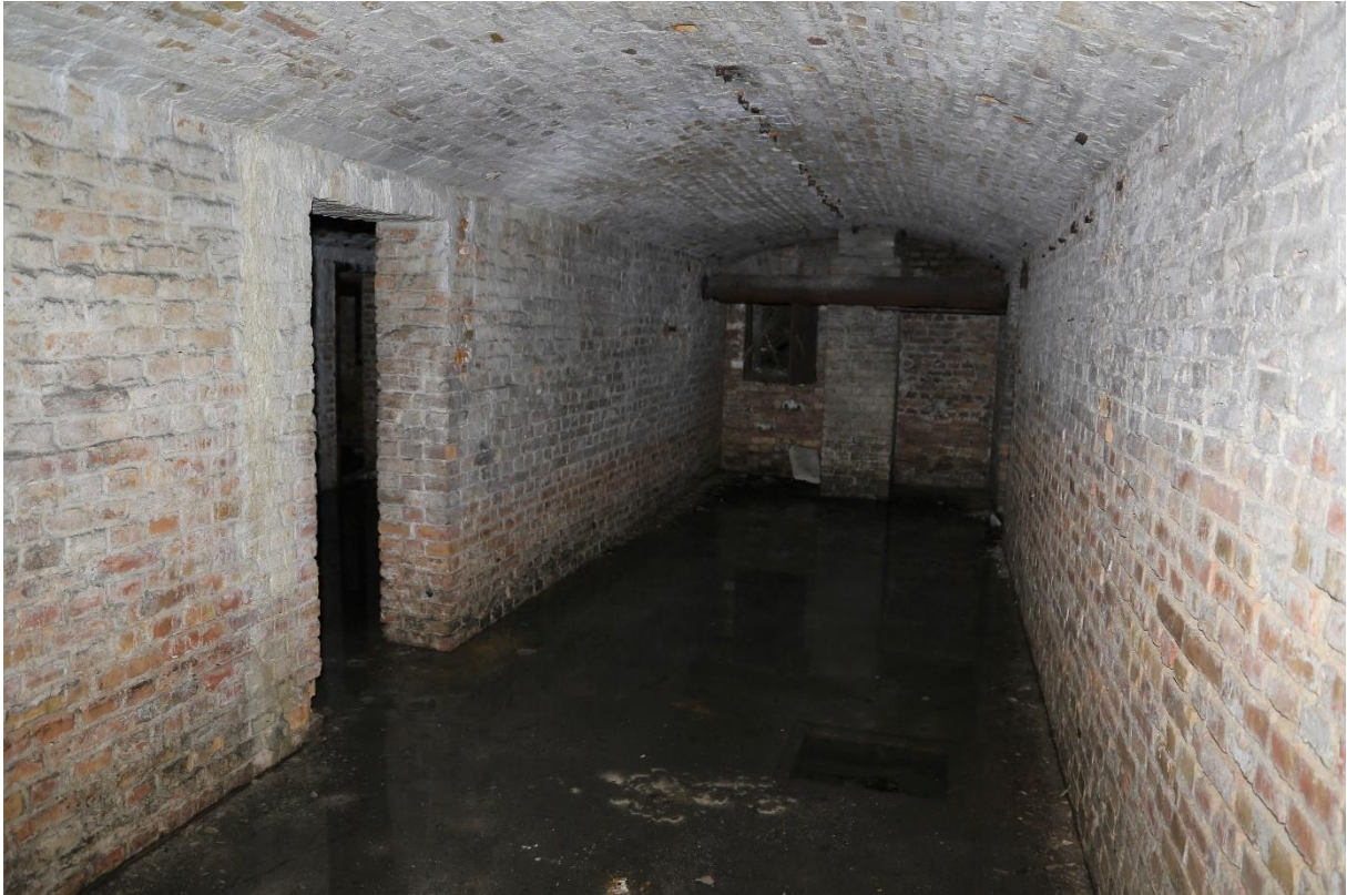
Abbildung 17: O.g. Keller, wasserführend, ganzjährig nass mit hoher Luftfeuchte.
