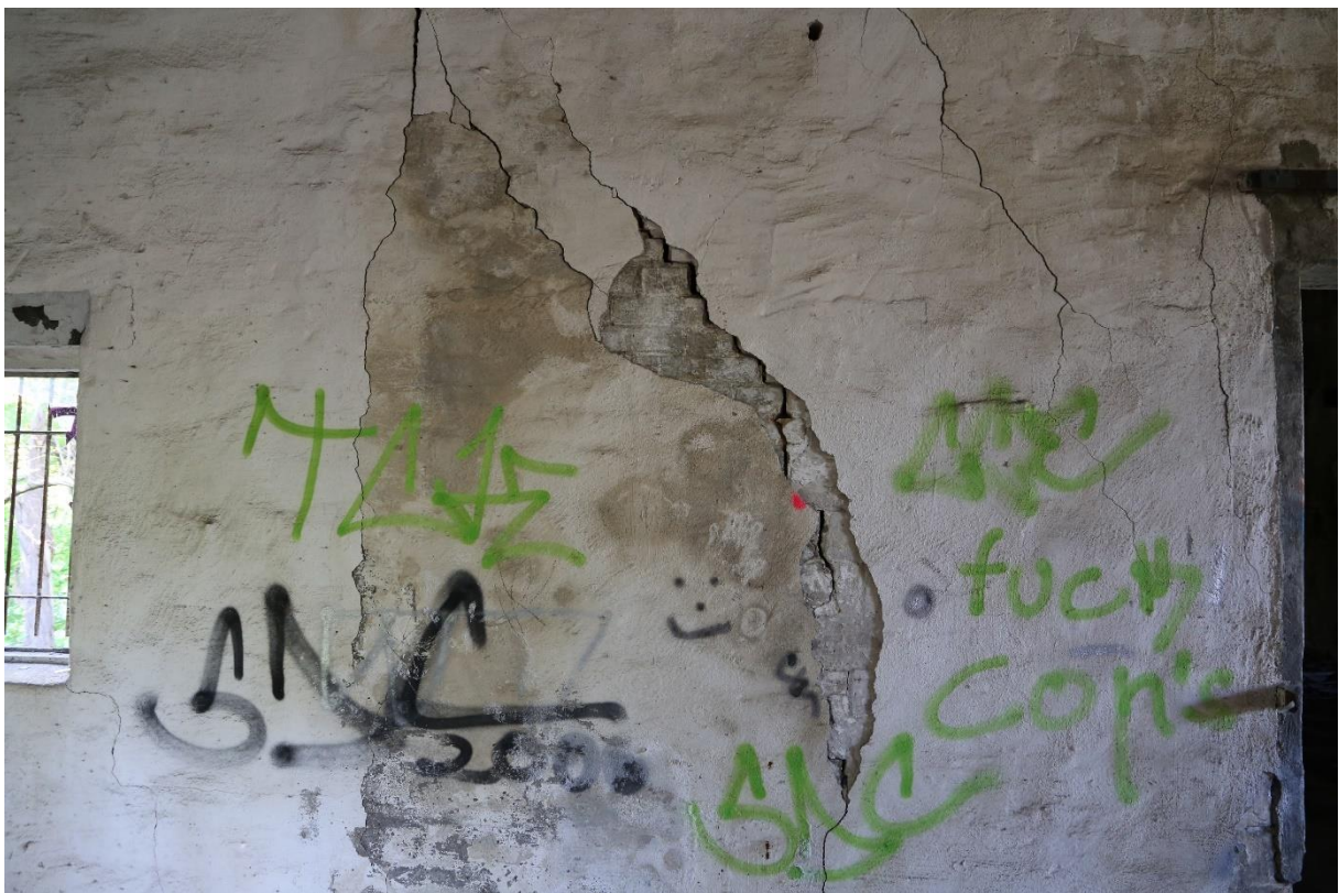
Abbildung 4: Die Gebäude weisen diverse potenzielle Quartierstrukturen (z.B. in Mauerwerksrissen) auf.
