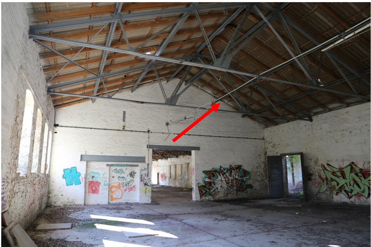
Abbildung 12: Werkhalle 5, Zwischenquartier Zwerg/ Mückenfledermaus an mittlerer Trennwand im Übergang zum Dach..
